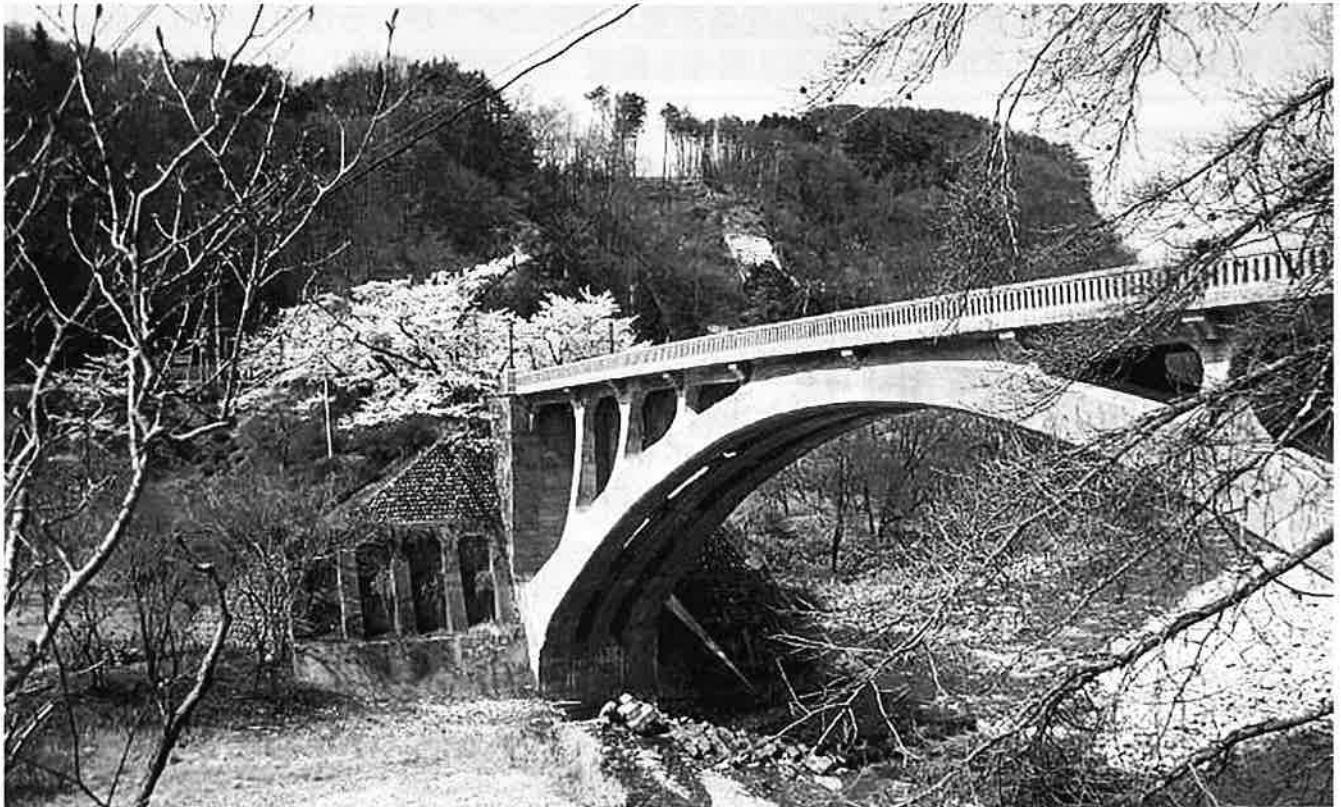
春の坂戸橋 坂戸橋は、上伊那郡中川村大草・片桐地籍の天竜川に架かる橋で昭和7年11月の竣工、橋長78m、幅5.5m、スパン70mの鉄筋コンクリート造単アーチ橋で、現存する昭和40年以前の鉄筋コンクリートアーチ橋では我が国最大を誇ります。平成22年1月国の登録有形文化財に登録されました。(写真提供：伊那建設事務所)
